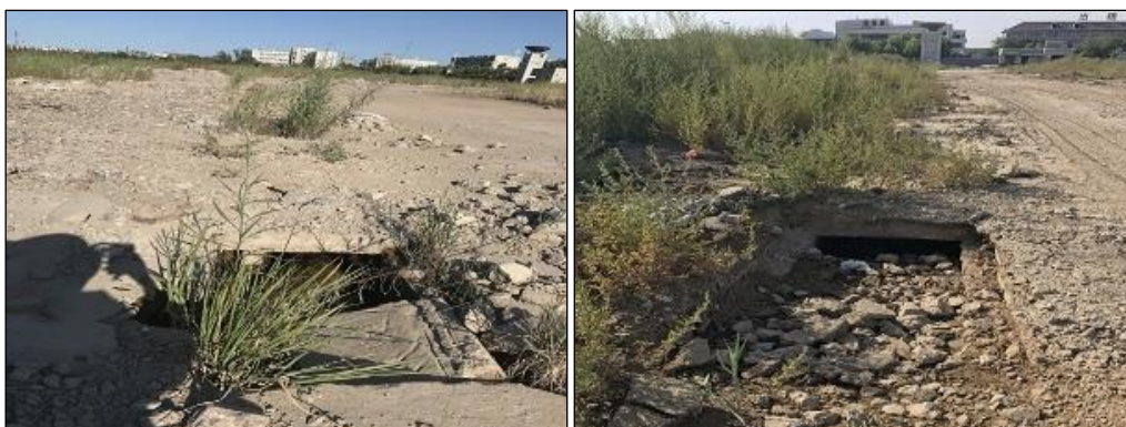
图 2-10 场地内裸露排水明渠
